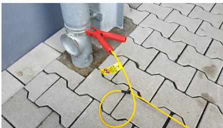
Erdung am Fallrohr
