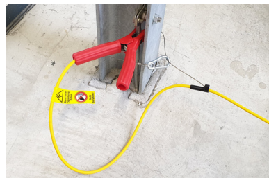
Erdung am Fundamenterder
